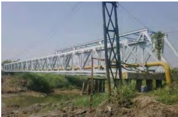
Kondisi pipa sudah mengalami pembengkokan akibat jembatan pipa gas yang sering mengalami banjir.
