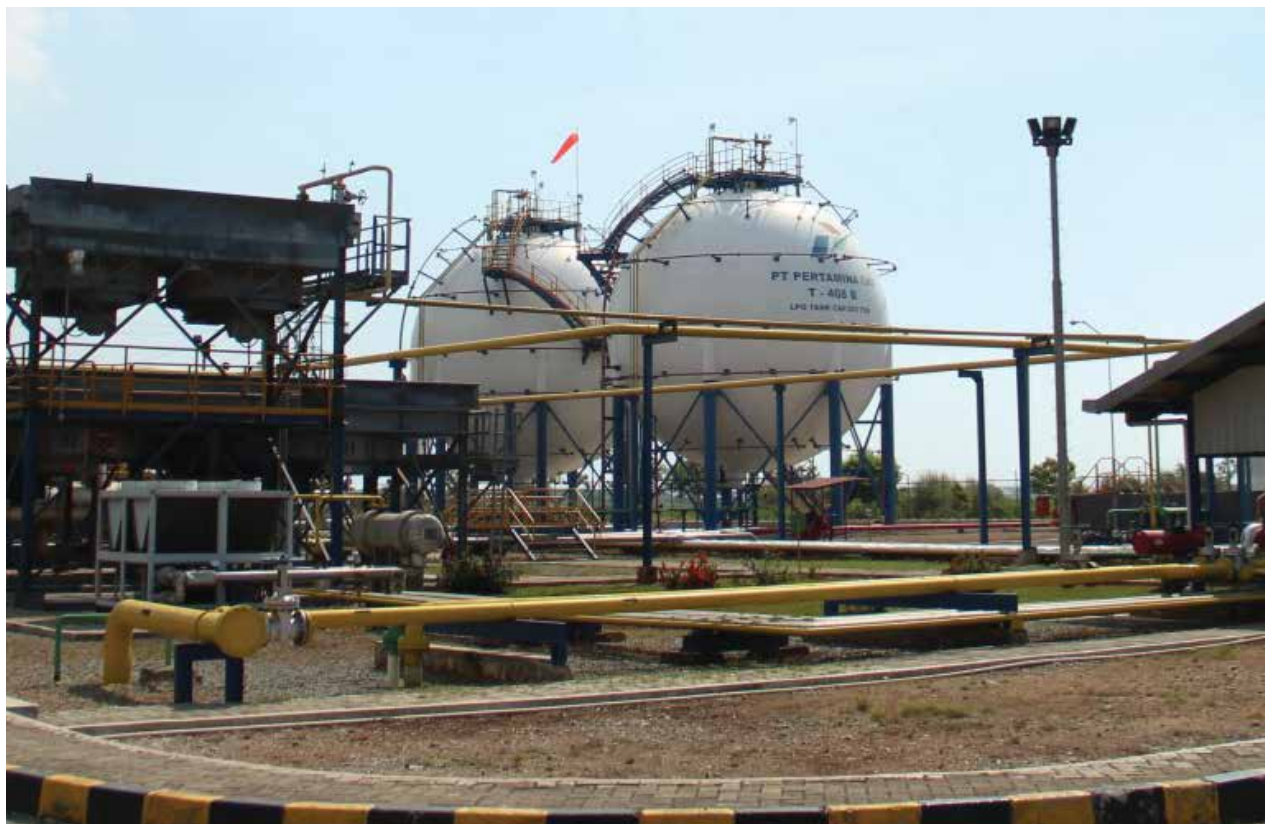
Salah satu fasilitas LPG Tank yang dimiliki oleh Pertagas untuk mendukung ketersediaan LPG nasional.
