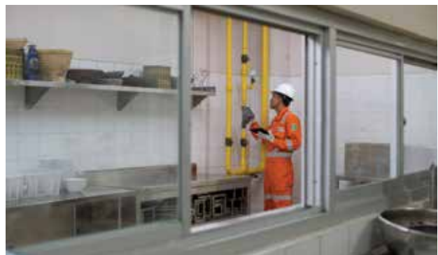
Untuk memastikan keamanan dan realibilitas penyaluran gas, staff PGASSol rutin melakukan operation dan maintenance atas fasilitas infrastruktur gas bumi.
