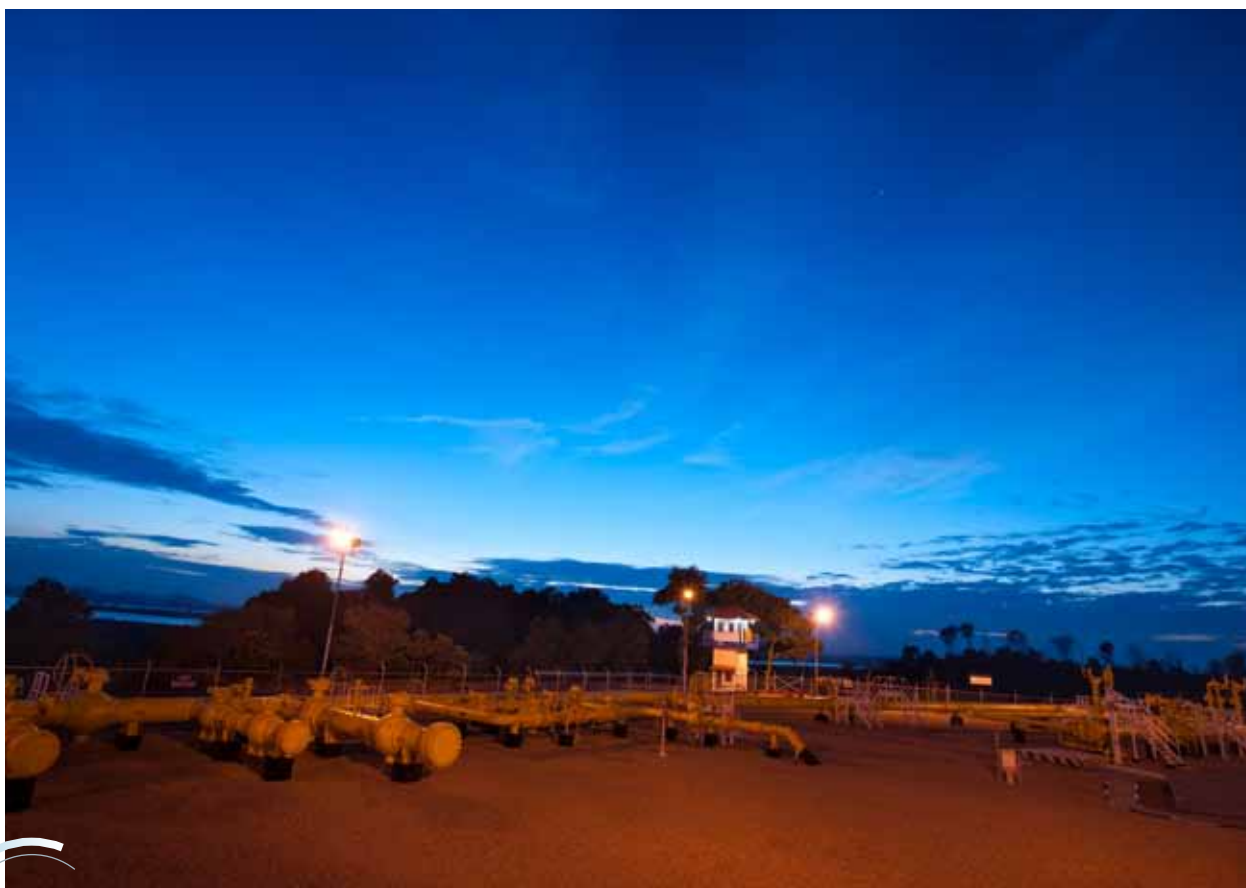
Fasilitas Stasiun penerima gas milik PT Transportasi Gas Indonesia, Entitas Anak PGN, yang berlokasi di Panaran, Batam
