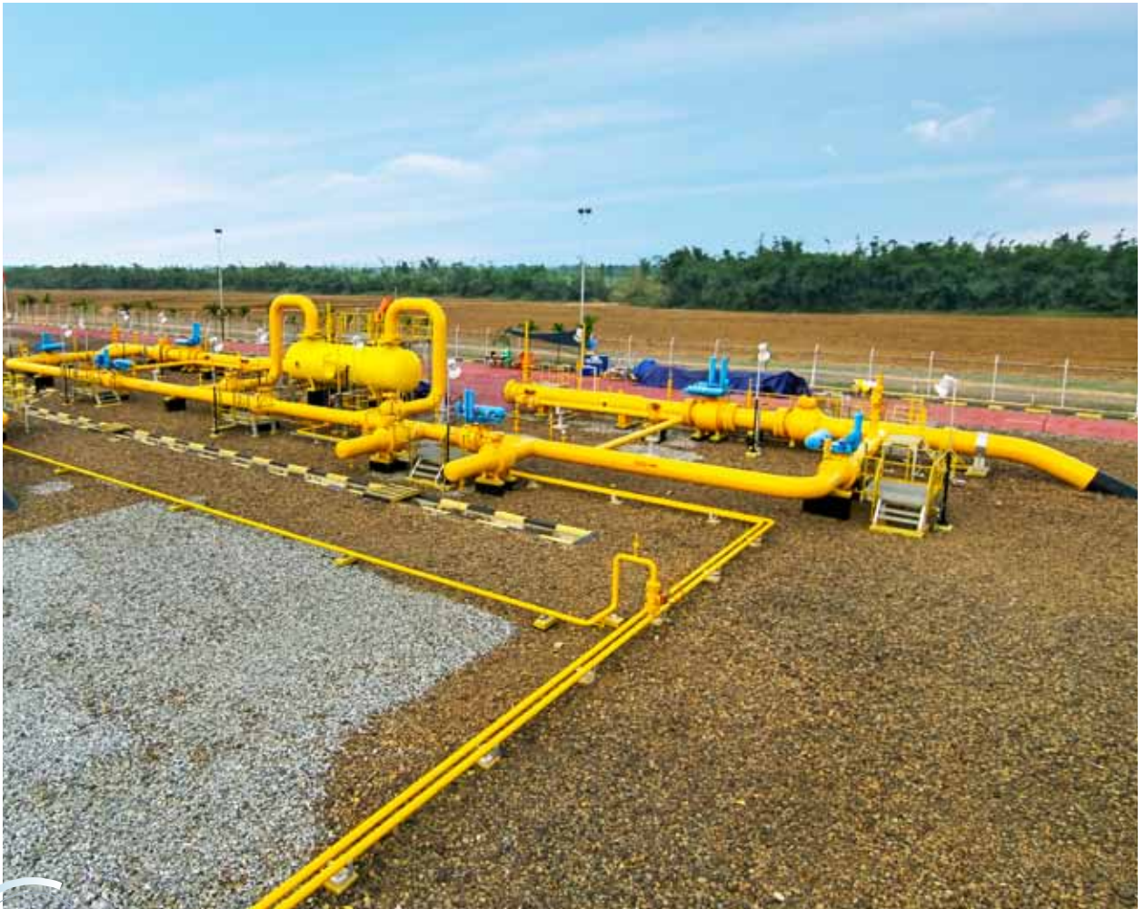
Stasiun gas Terbanggi Besar yang berada di jalur Pipa Transmisi SSWJ (South Sumatera West Java) Kilometer Pipa 171,3 dibangun di daerah provinsi Lampung, Sumatera. Dengan luas area 16 Ha, stasiun ini berfungsi sebagai control pressure dan temperature untuk menjamin kelancaran dan keselamatan dalam upaya mentransmisikan gas. Dibangun pada tahun 2006 dan beroperasi pada tahun 2007.
